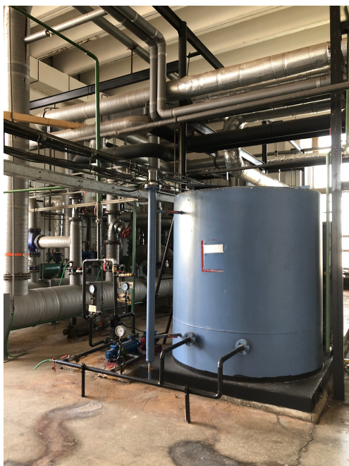
Obrázok č. 18 – Úpravovňa vody pre TÚV
