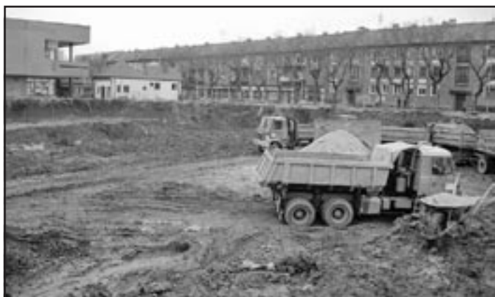
V tejto veľkej jame vedľa Univerzálu bude polyfunkčný dom s podzemným parkoviskom.
